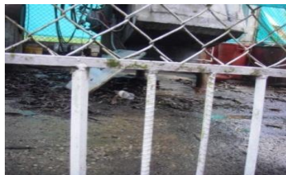
Foto 25 incinerador con basura en su interior.
