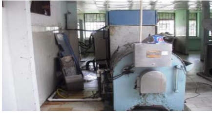
Foto 34 maquina lavadora obsoleta.
