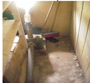
Foto 46 tubería de salida de la lavandería.
