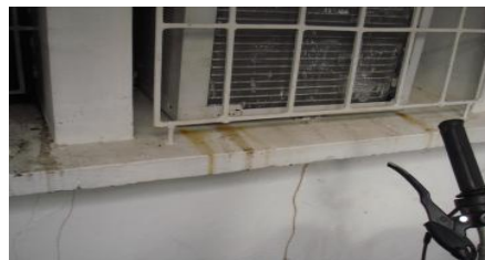
Foto 18 Aire acondicionado con humedades.
