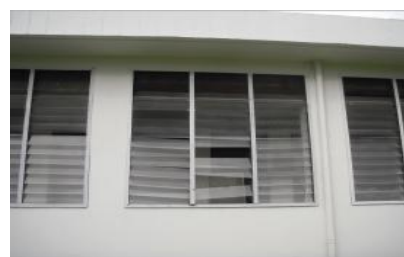
Foto 21 consultorios con vidrios rotos.
