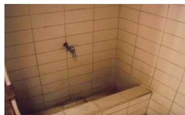
Foto 33. Llave de agua donde lavan trapeero de la cocina.
